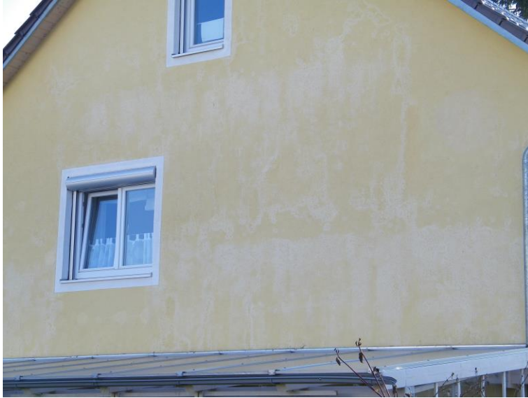
Kalkausblühungen an der Fassade
