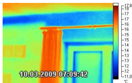
Wärmebrücke Betonsturz über Fenster
