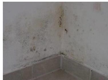
Schimmelbildung aufgrund von Kondensat auf einer Kellerinnenwand
