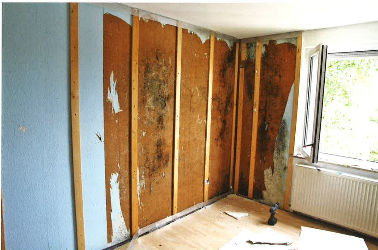
4 Verborgener Schimmelpilzbefall hinter einer Verkleidung.
