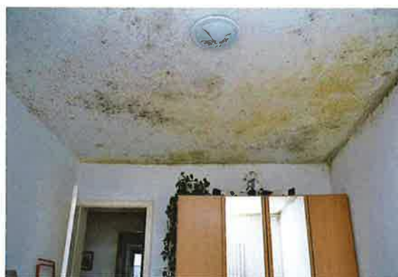
3 Flächendeckende Schimmelbildung. Die Ursache ist nicht auf den ersten Blick erkennbar.
