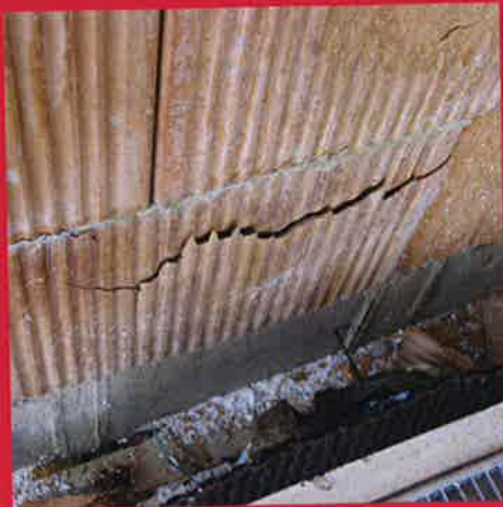
Frostschäden im Mauerwerk.
