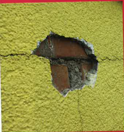
Putzriss aufgrund wechselnder Putzdicken.
