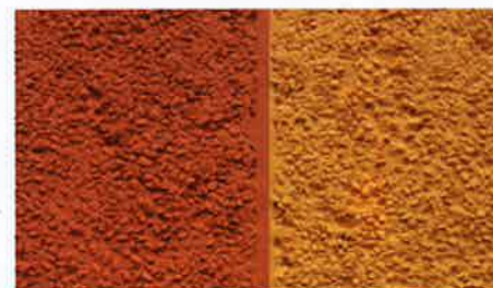
Bild 6: Oberfläche der Waschbetonplatten an der Willy-Brandt-Straße in Cottbus nach der farblichen Beschichtung mit einer Reinacrylatfarbe
