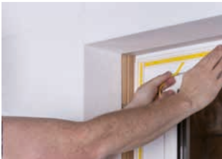
Ankleben des Anschlussprofils. Der vordere Schenkel muss bündig zur Vorderkante des Bordprofils der Fensterbank ausgerichtet werden.
