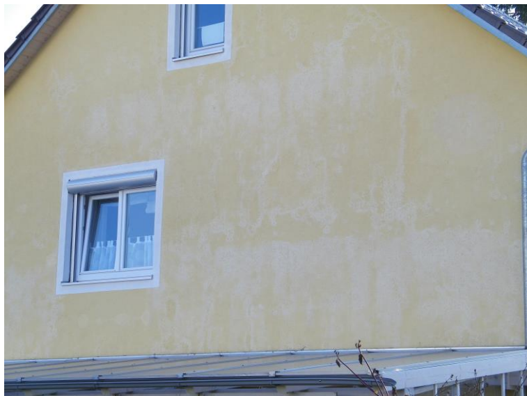
Kalkausblühungen an der Fassade
