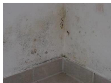
Schimmelbildung aufgrund von Kondensat auf einer Kellerinnenwand
