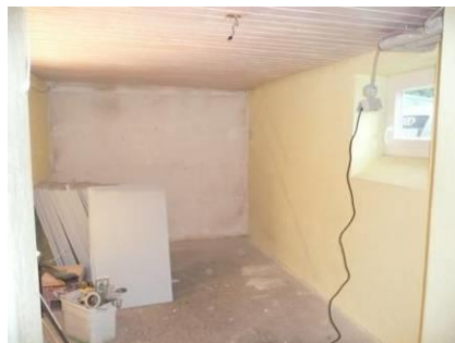
Schimmelbehandlung mit handelsüblichem Peroxid im Kellerraum
