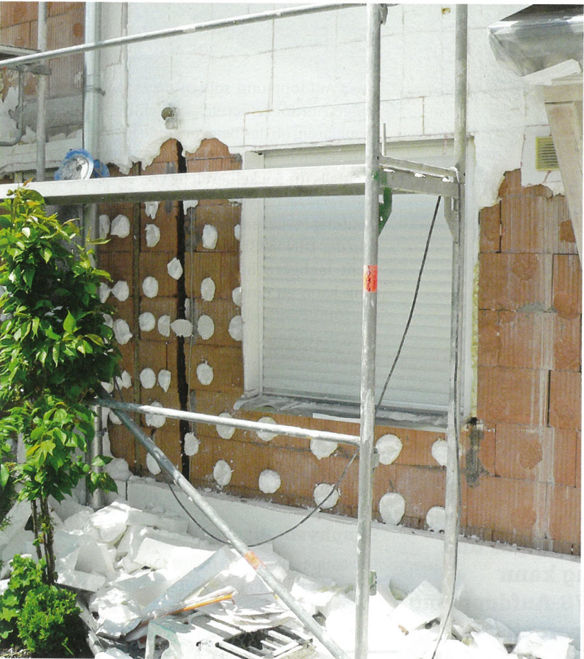
Bauteilöffnung im Fassadenbereich: Fehlerhafte Verklebung.
