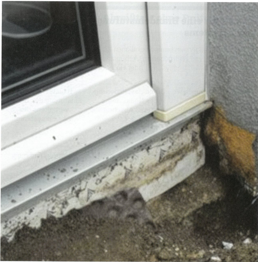
Bauteilöffnung im Sockelbereich: Fehlende Bauwerksabdichtung.
