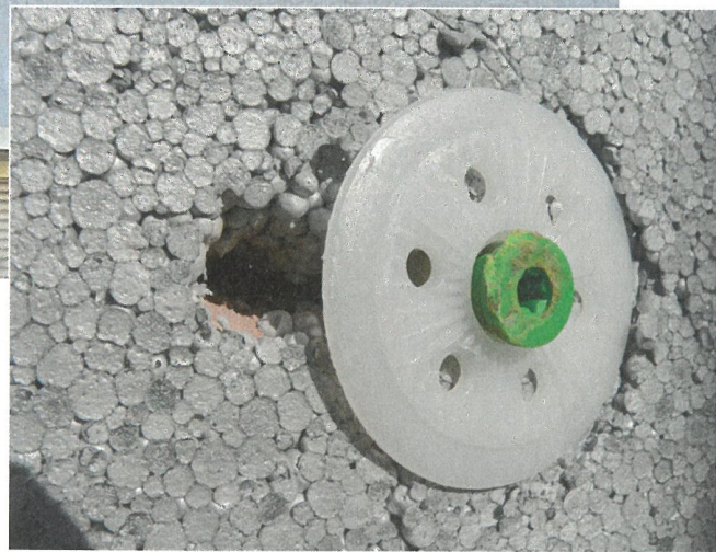
Dübelabzeichnungen können durch zu tief (oben) oder zu hoch (unten) gesetzte Dübel verursacht werden.
