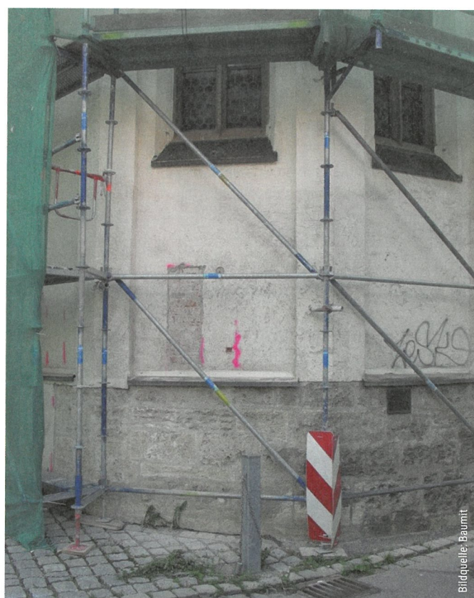
Abb. 3: An dieser Kirche zeigte sich nur im unteren Bereich ein Feuchterand im Putz. Bei der anschließenden Untersuchung konnten allerdings noch in einer Höhe von 6 Metern Nitratsalze nachgewiesen werden.
