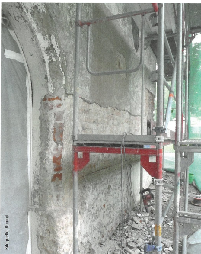
Abb. 2: Gerade wenn der Putz sehr hart ist, ist man versucht, möglichst wenig davon abzunehmen. Das kann sich allerdings schnell rächen, wenn unter dem dichten Putz die Salze sehr hoch gestiegen sind. Bei vorgesetzten Sockeln ist manchmal eine Ausnahme angesagt, wenn, nicht so wie hier, der Sockel „vorbetoniert“ wurde. Das Abnehmen würde in diesem Fall einen zu hohen Substanzverlust im Mauerwerk nach sich ziehen.
