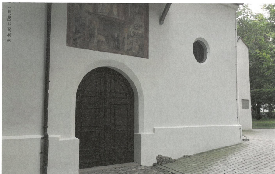
Abb. 5: Durch den vorgesetzten Altputzsockel bleiben Regen und Schnee lange liegen, sodass diese Bereiche mit dem Sockel inzwischen einmal nachgestrichen wurden. Die Restflächen können sich nach über 10 Jahren aber noch gut sehen lassen.
