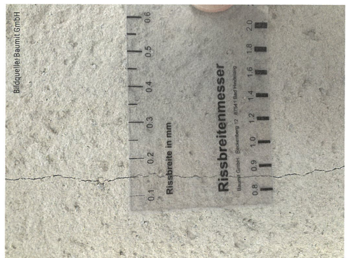
Abb. 3: Sehr feiner, kaum sichtbarer Haarriss mit geringer Rissbreite, entstanden durch thermische Belastung oder Trocknungsvorgänge im Oberputz.
