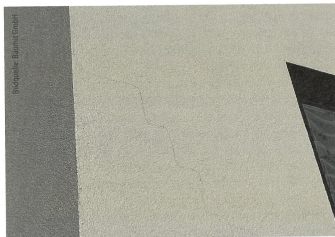
Abb. 5: Treppenartig in den Lagerfugen verlaufender Setzungsriss als deutlicher Hinweis auf unterschiedliche Bauwerksbewegungen im Mauerwerk.
