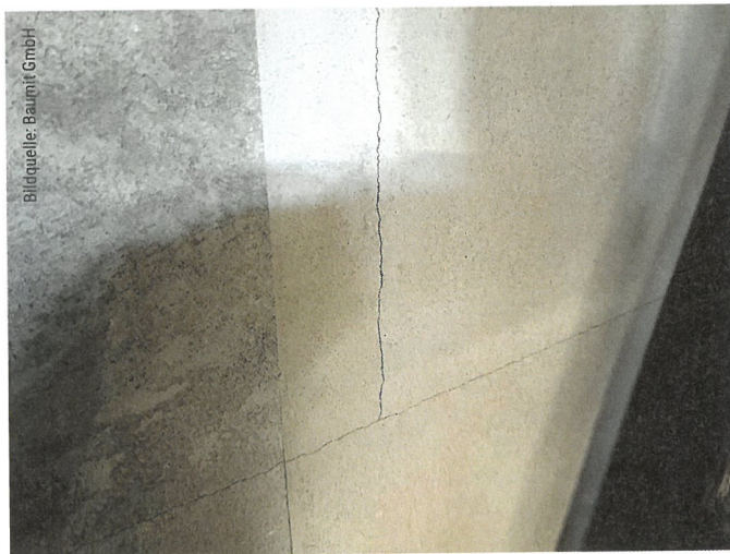
Abb. 4: Markanter Spannungsriss, der die direkte Übertragung von Bewegungen aus dem Putzgrund auf die starre Putzschale erkennen lässt.
