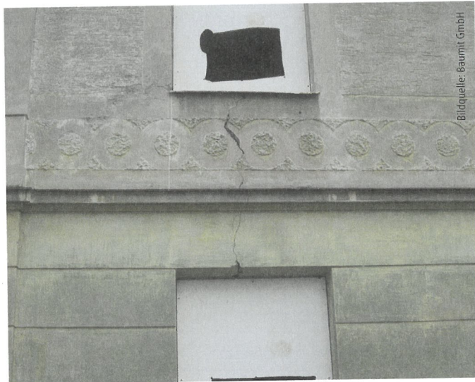
Abb. 5: Riss im Mauerwerk, bauwerksbedingt.
