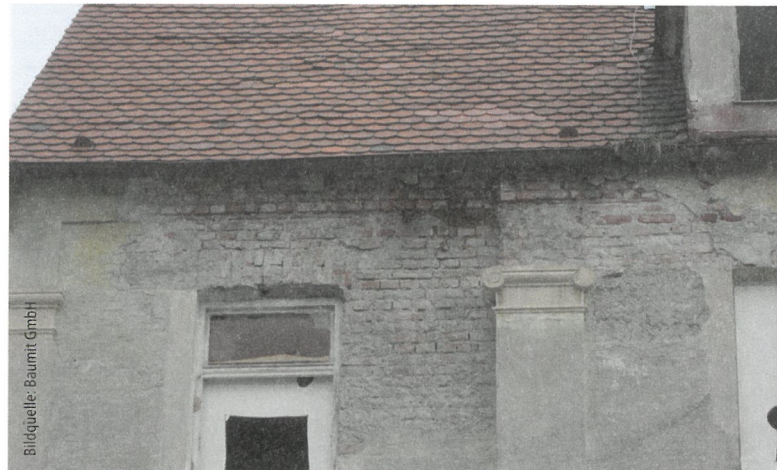
Abb. 3: Detail Feuchteschaden im Dachbereich.
