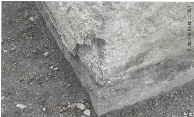
Abb. 4: Detail Feuchte- und Putzschäden im Sockelbereich.
