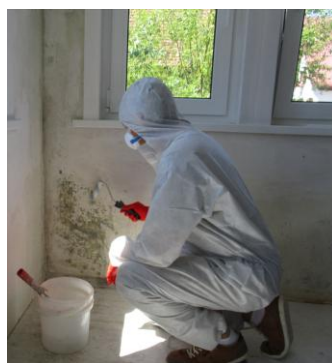
Schimmelbehandlung mit handelsüblichem Peroxid
