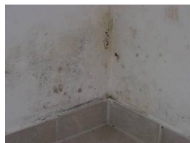
Schimmelbildung aufgrund von Kondensat auf einer Kellerinnenwand
