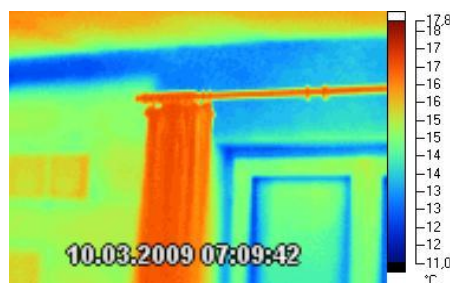
Wärmebrücke Betonsturz über Fenster
